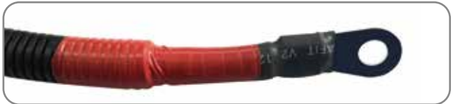
ECU Power/ Fan Power
